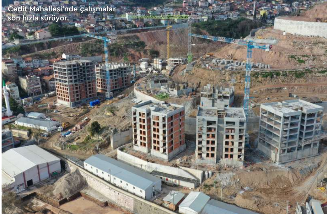
İzmit Cedit Mahallesi'nde tüm yapıların yıkım ve tahliye işlemleri bitti, projenin yüzde 30'u tamamlandı.
