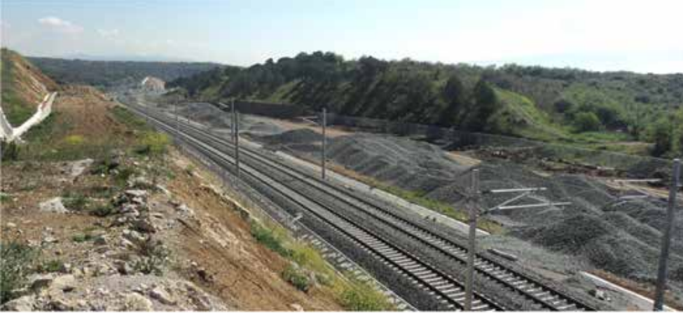
Foto 2. Dinotherium sp. fosilinin bulunduğu Kazmalı Dere vadisinin doğusundaki sırtta, hızlı tren hattı yapım çalışmaları nedeniyle 2013 yılında açılan yeni yol yarmalarının görünümü.
