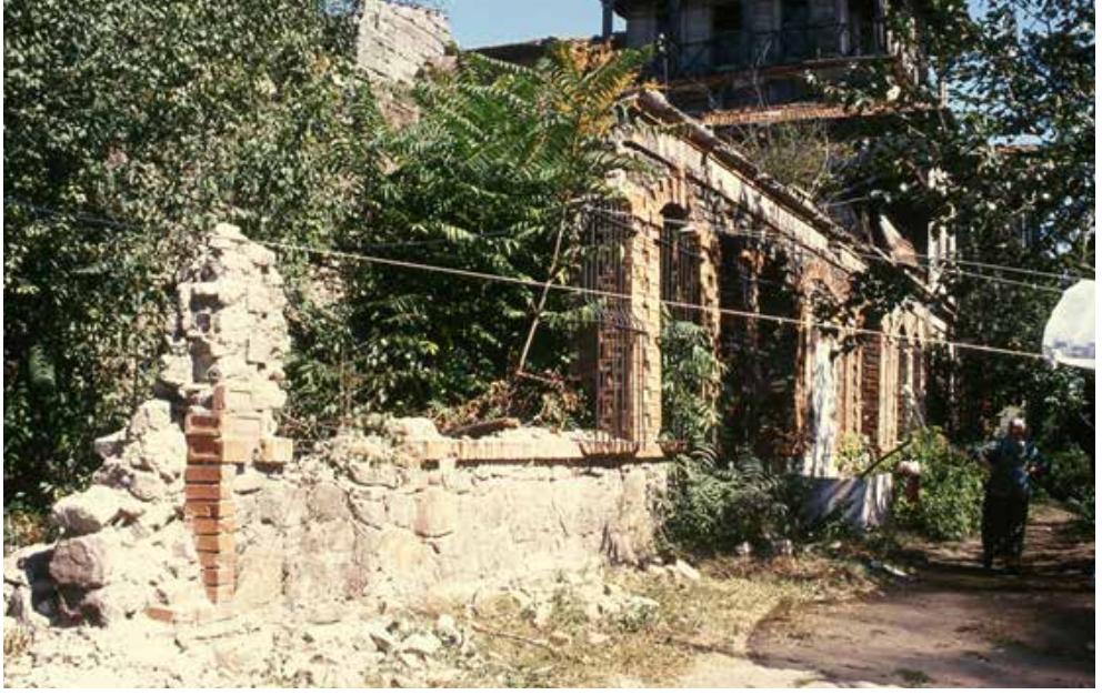
Şekil 2- Sırrı Paşa Konağı, 1999 depremi sonrası görünüş
