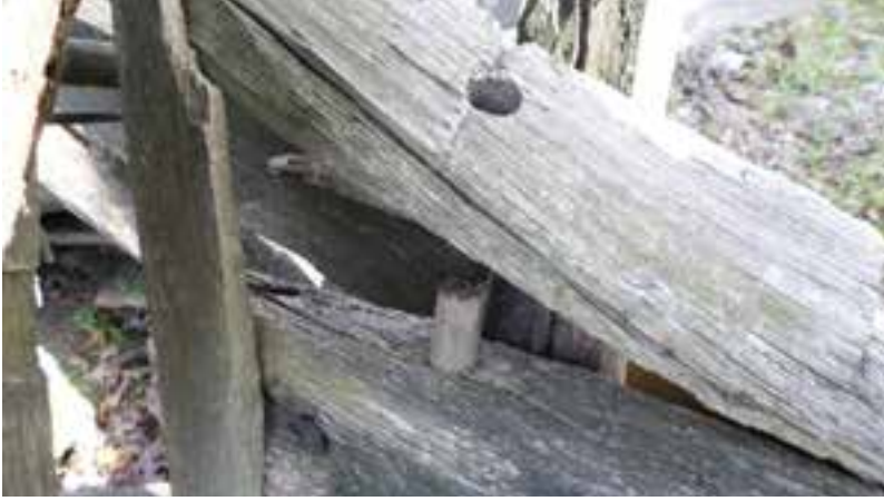
Şekil 17: Kütükçüler Köyü Orhan Camii çandı duvar içindeki ahşap çivi detayı
